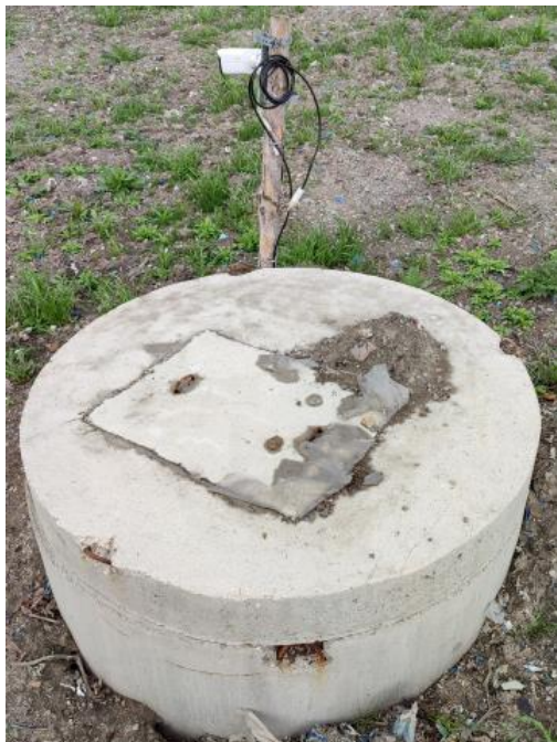
Fot. 1 Studzienka odgazowująca S1
