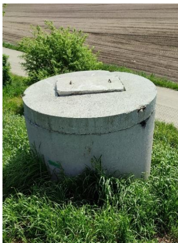
Fot. 3 Studzienka odgazowująca S3
