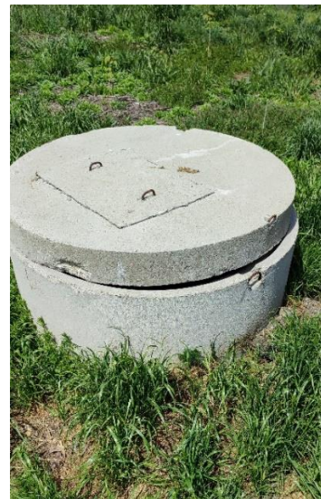
Fot. 2 Studzienka odgazowująca S2
