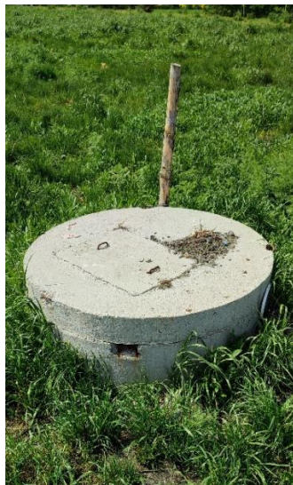
Fot. 1 Studzienka odgazowująca S1
